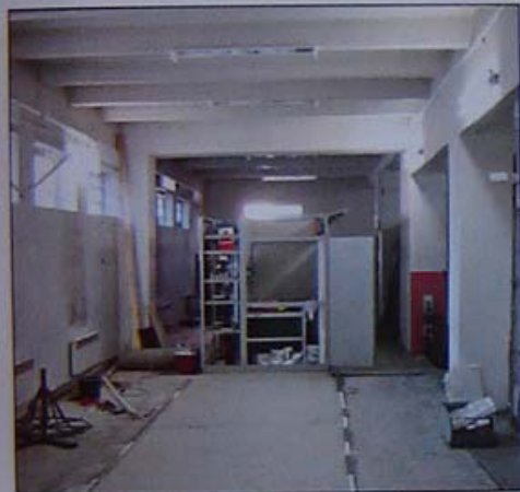
V popředí připravená podlaha pro novou část ss rozvaděče vzadu již nová část SS rozvaděče pod napětím.
