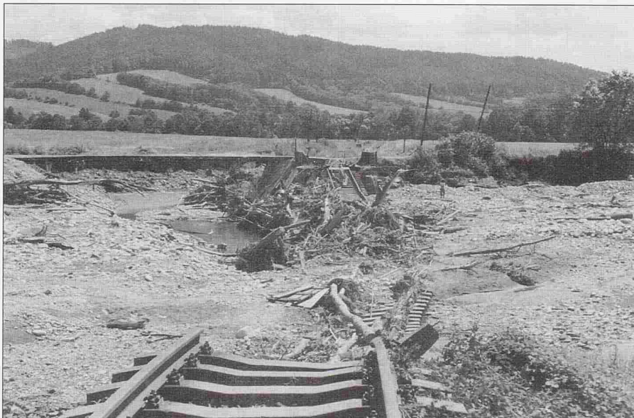
Zničený úsek trati mezi Petrovem nad Desnou a Rapotínem foto J. Březina
